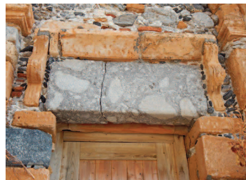
Ρωγμές του χρόνου και της λησμονιάς των ανθρώπων στο υπέρθυρο και στη νότια τοικοποιία. Ο ναός χρήζει άμεσης συντήρησης και αποκατάστασης των φθορών.
